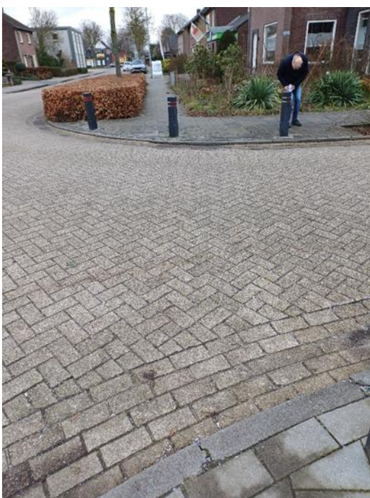
c. Hoek Quackelaer - Schoolstraat. Oversteekplaats onduidelijk en oneffen.
